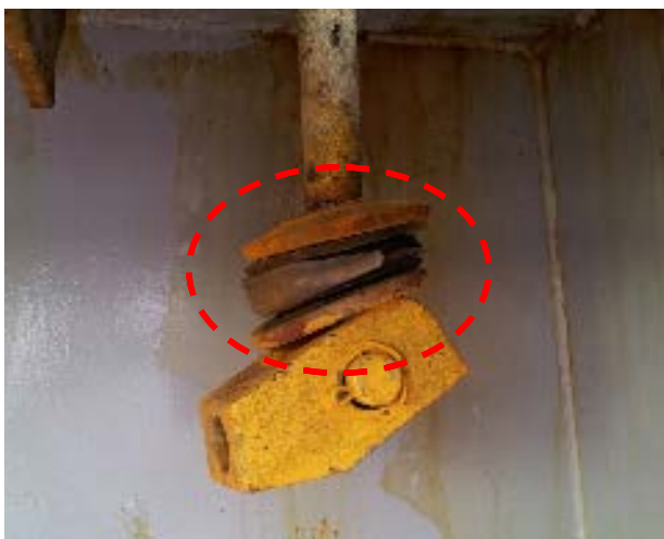
ラバー ワッシャーの損傷
