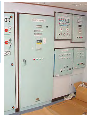
酸素濃度監視パネル
