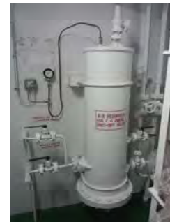
FOT遮断弁閉鎖用空気タンク
