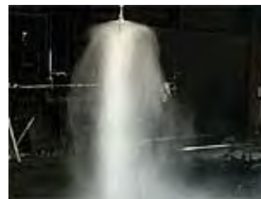
局所消火装置
