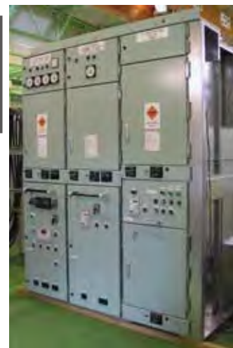
高圧配電盤 (JRCS殿提供)
