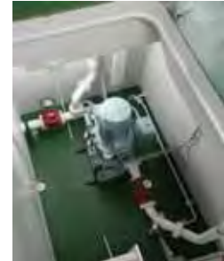
非常用消火ポンプ
