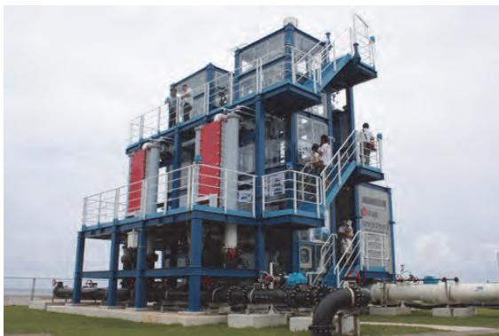
図8 実証発電プラント（久米島）
