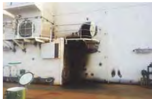
※排ガスの放出先の例 (閉囲区画ではないが人的被害の危れあり)
