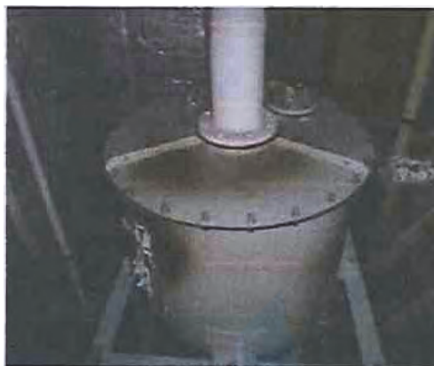
写真1 薬剤貯蔵タンクの焼損
