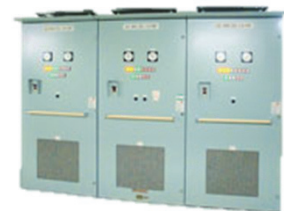
インバータ制御盤 (西芝電機殿HPより)
