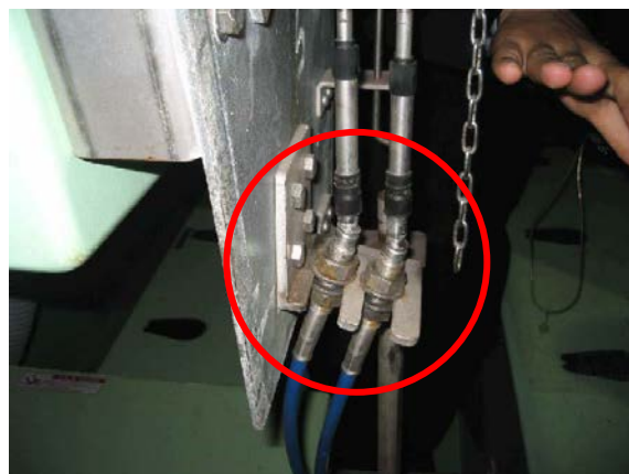
Release 케이블과 브래킷이 구부러진 상태
