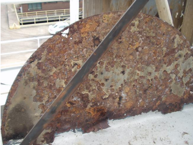
방화 댐퍼의 손상/천공
