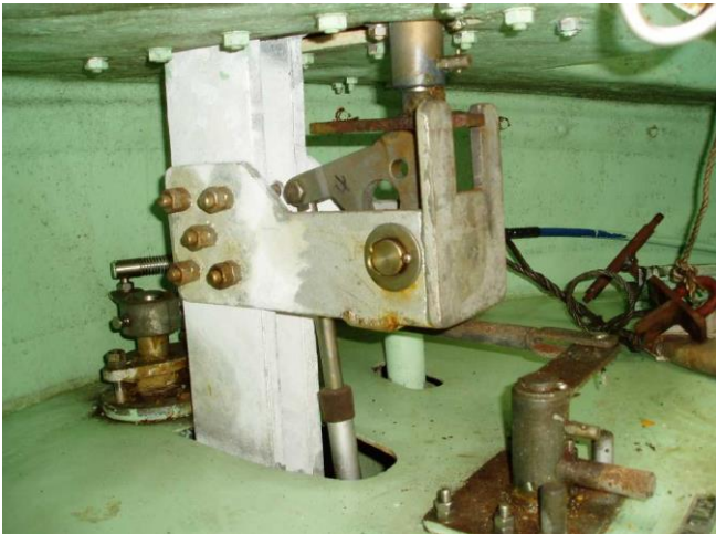
부적절하게 설치한 경우
