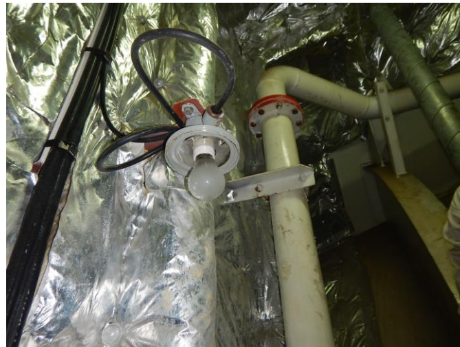
E/R 조명기구의 가드가 유실된 상태
