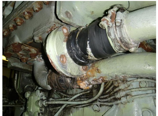
G/E 의 SW 배관에 고무 패치를 이용한 부적절한 수리
