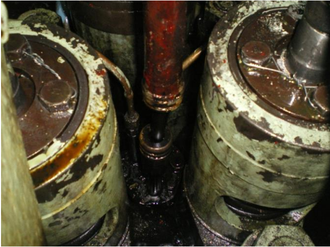
고압 연료유 배관 더블링 자켓의 일부가 부족한 상태
