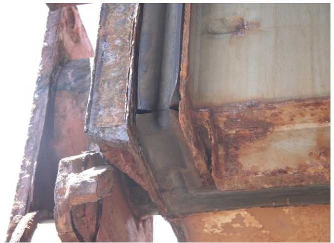
고무 패킹의 경화와 균열
