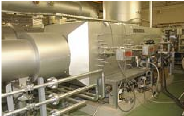
SCRシステムの外観
