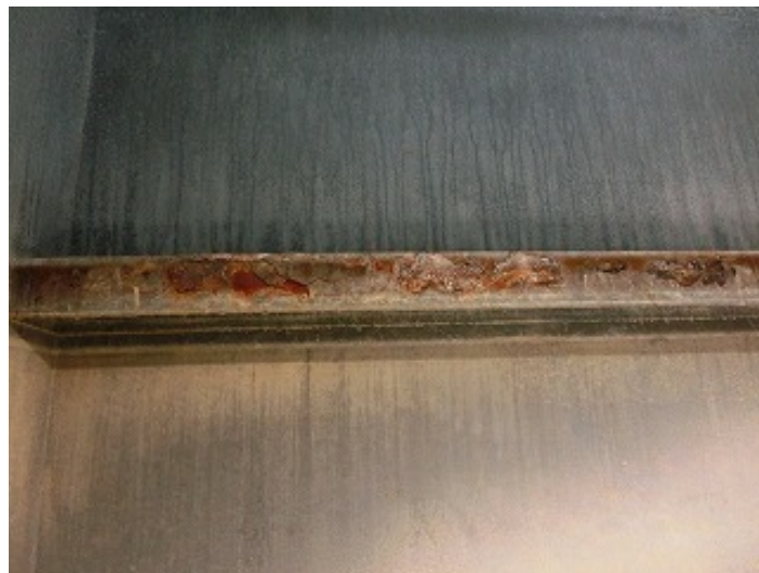
一部の壁面のロンジ水際部で、腐食が進行している
