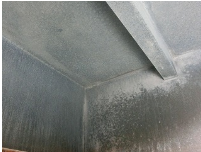
非没水部において白錆が多い
