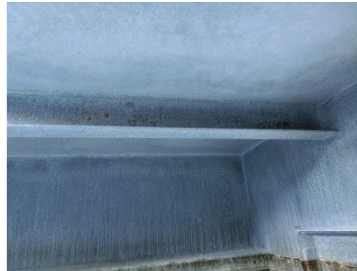
非没水部で発錆が一部見られる
