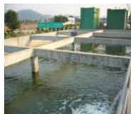
油水処理施設 (中国)
