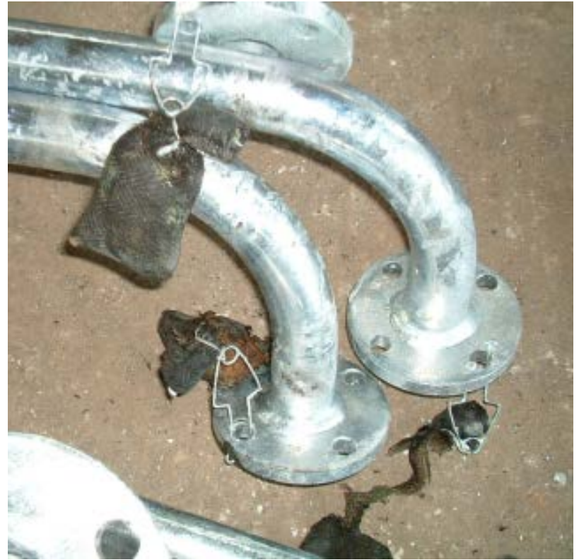
付いている物と破断している物
