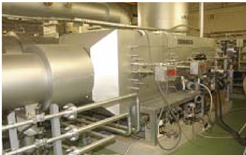
SCRシステムの外観
