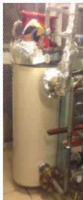
電気ヒータ(熱交換機代替)
