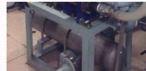
サージタンク
