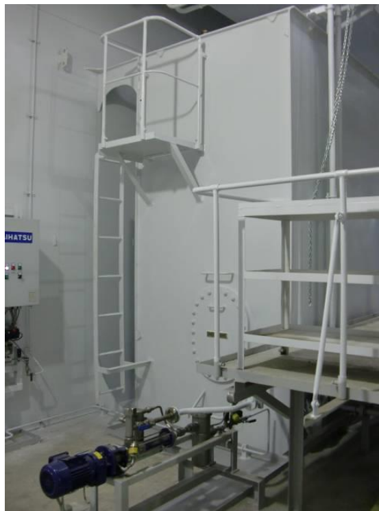
上:尿素水タンク 下:ポンプ
