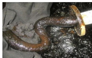
閉塞したスラッジ配管
