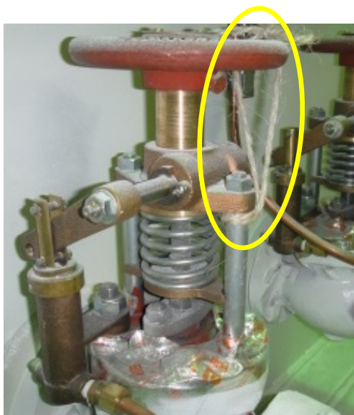
ロープにより固縛された緊急遮断弁
