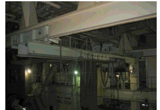
機関室天井クレーン
