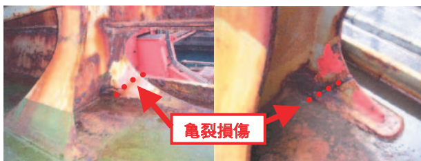
図28 ブルワークステイ基部における損傷（ガセットタイプ）
