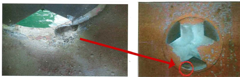
写真2 ディスタンスピース-bluff body 溶接部付近の腐食
