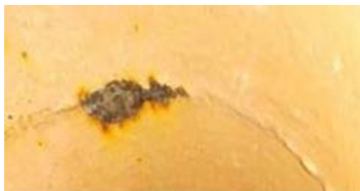
写真3 突合せ溶接部近傍の塗装の剥離
