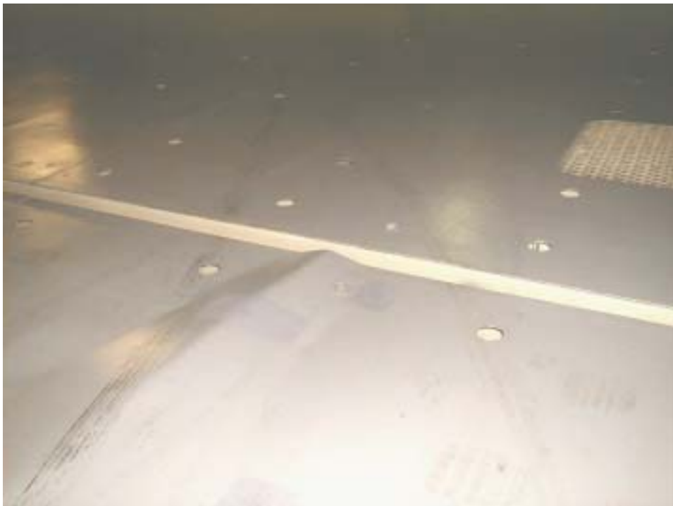
写真2 デッキプレートの異常な変形(上に凸)
